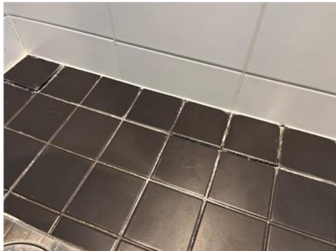
Lösa klinkerplattor längs yttervägg i dusch.
