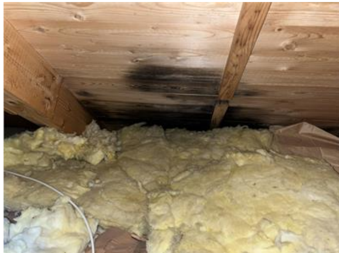
Mindre fuktfläck på vinden
