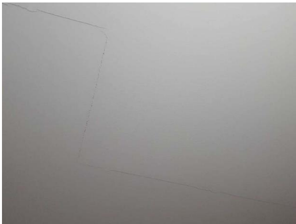
Bild 2: Invändigt, Entréplan, Tv-rum, Noterat spricka i gipstak.
