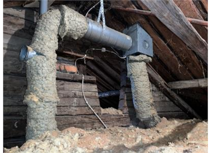
Ventilationsanläggning på vinden
