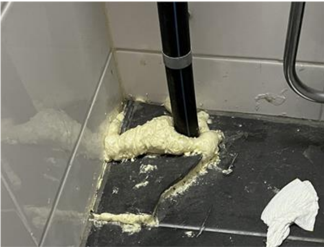
WC entréplan: Skada i golv orsakat av fogsium
